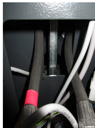
Posición y orientación de las mangueras hidráulicas y cables.
