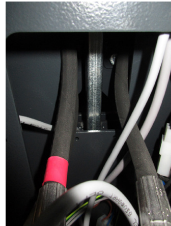
Lage und Orientierung der Hydraulikschläuche und -kabel.
